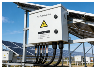
PV String Boxes
